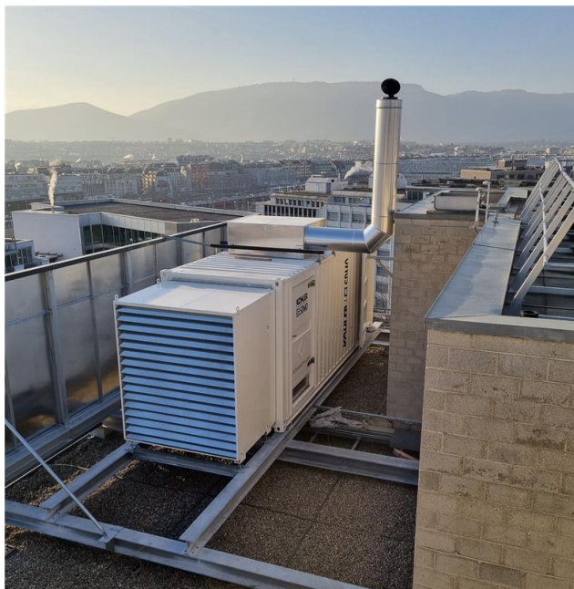
Abbildung 8: Typischer Aufbau auf Hausdach mit Dieselaggregat, Tank, Lüftung, Lärm- und Sichtschutzwand sowie Kamin.
