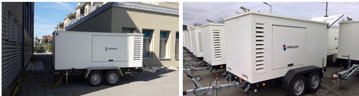
Abbildung 9: Typische mobile Diesel-Notstromaggregate unterschiedlicher Kapazität.
